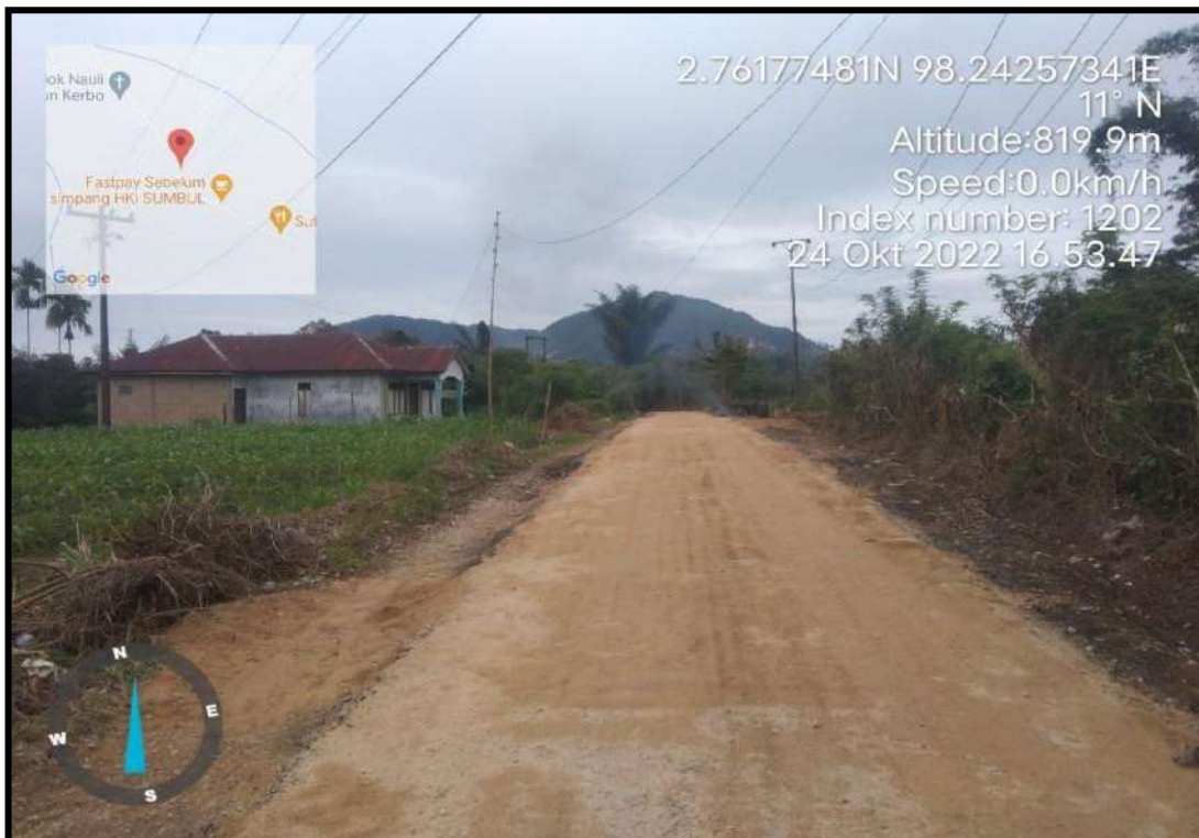
Dokumentasi Pemeliharaan Periodik Jalan Jrs. Berampu - Juma Petak, Link. 175, Kec. Berampu (Pemeliharaan Berkala Jalan)
